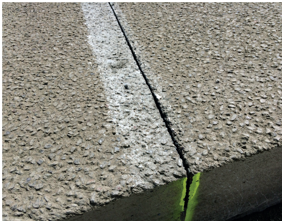
Rys. 2. Widok makrotekstury nawierzchni betonowej z odsłoniętym kruszywem
