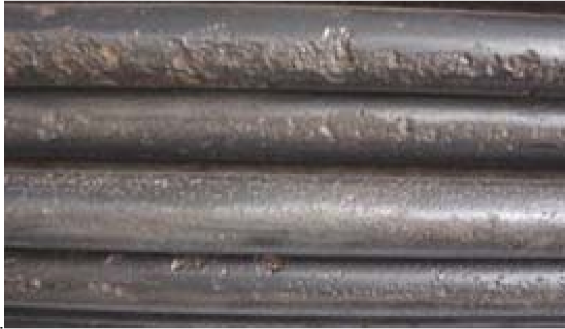
Rys. 9. Ubytki korozyjne na rurach stalowych
