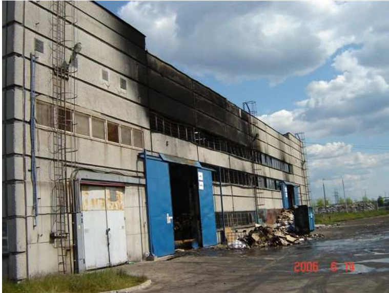
RYSUNEK 7.24: Hala po pożarze (widok z zewnątrz) [fotografia z oględzin popożarowych].
