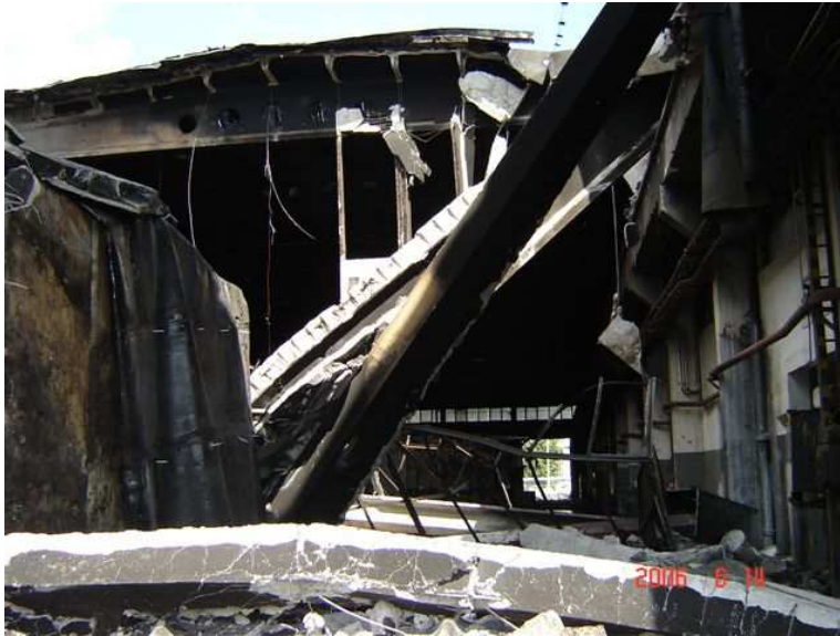
RYSUNEK 7.25: Ściana działowa (widoczna po lewej stronie) [fotografia z oględzin popożarowych].
