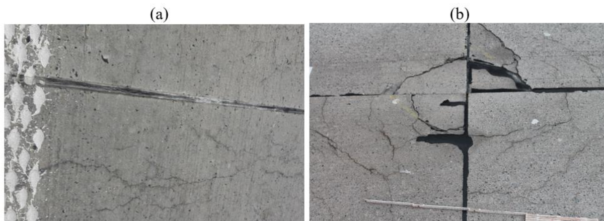
Rys. 8.1 Przykłady spękań zaobserwowanych na (a) drodze ekspresowej położonej w środkowej Polsce wybudowanej w latach 2002-2003, (b) autostradzie niemieckiej wybudowanej w 1996 roku
